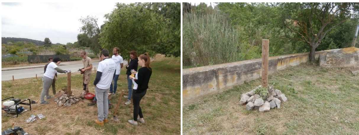
Proceso constructivo en la zona 1 / Zona de refugio terminada en la Zona 2
