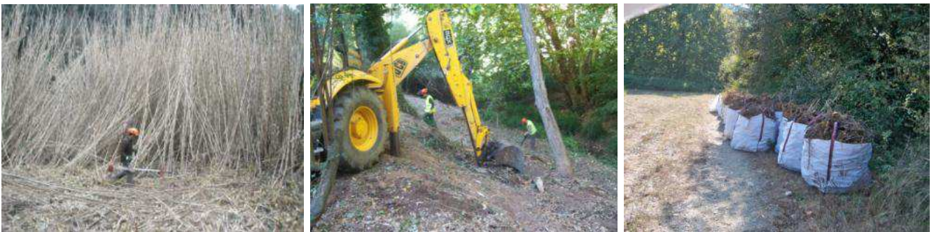
Imatges de l'estat inicial de la riera, el procés d'eliminació del rizoma amb retroexcavadora i l'ensacada per poder retirar de la llera.
